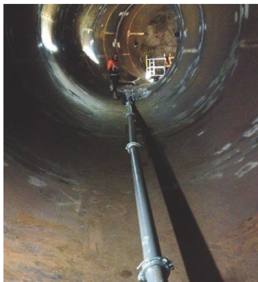
Pompage sur 120 ML pour injection du béton autoplaçant par guillotine avec contrôle des pressions d'injections.
